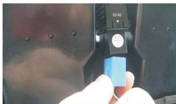
14 拔掉空调出风口面板后面的应急灯开关插座
