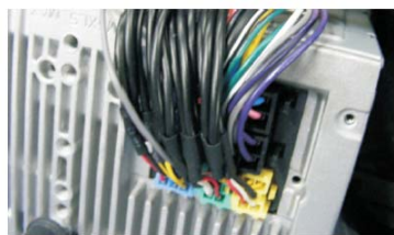
28 将尾部的线束均匀摊开, 整理线束紧挨尾部
